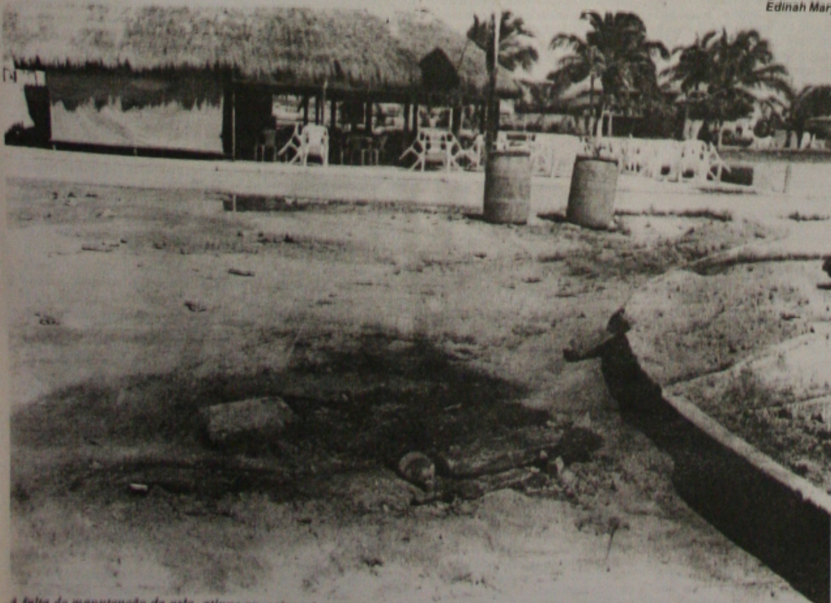
A falta de manutenção da orla atinge as caixas da rede de esgotos que, abertas, exalam mau cheiro para os bares próximos
