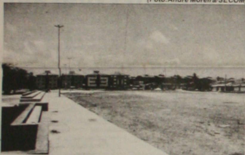
O campo do Augusto Franco passa por uma reforma total e ganhará quadras poliesportivas e estacionamentos
