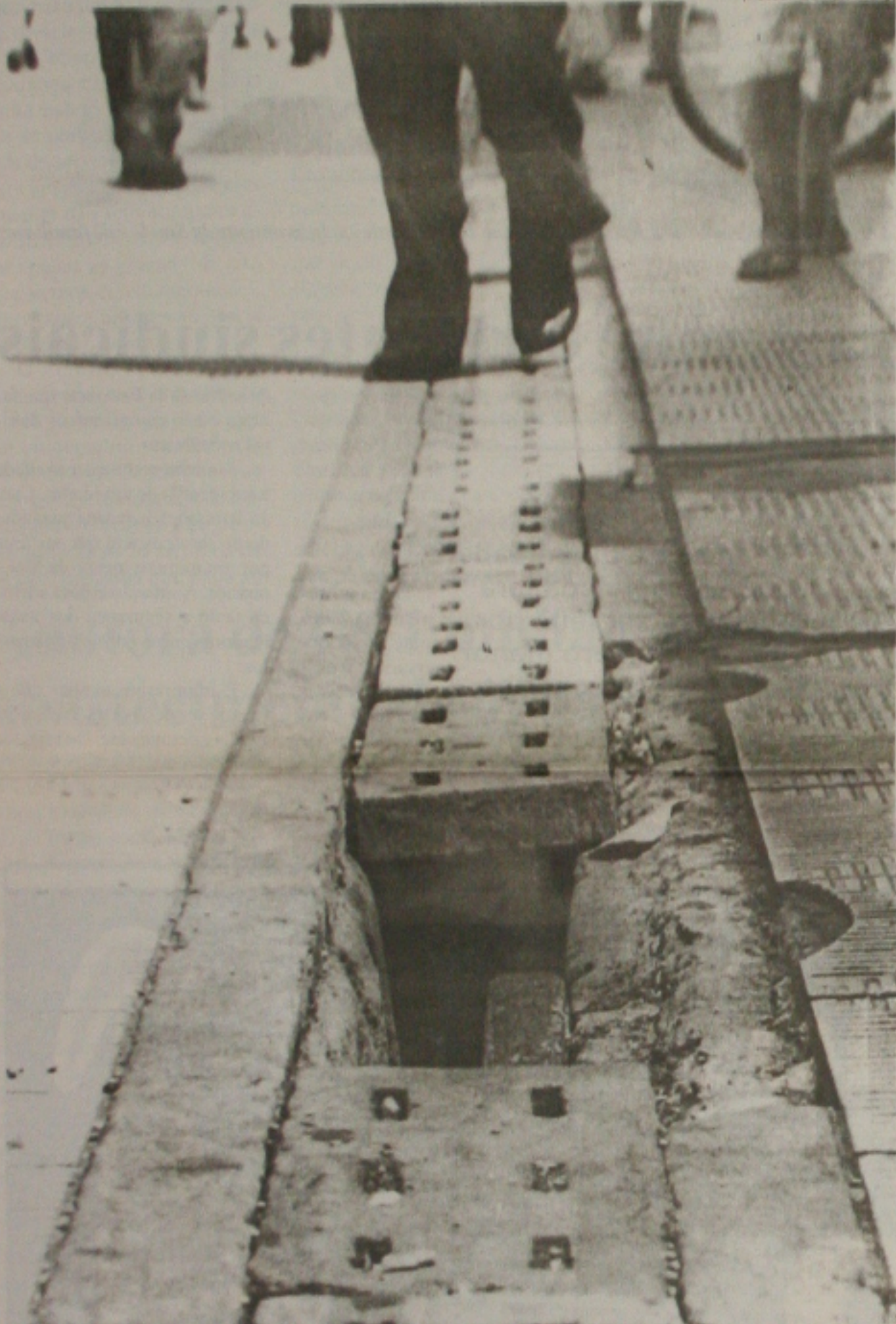
As tampas dos esgotos danificadas e a sujeira ofuscam a beleza dos calçadões do centro de Aracaju
