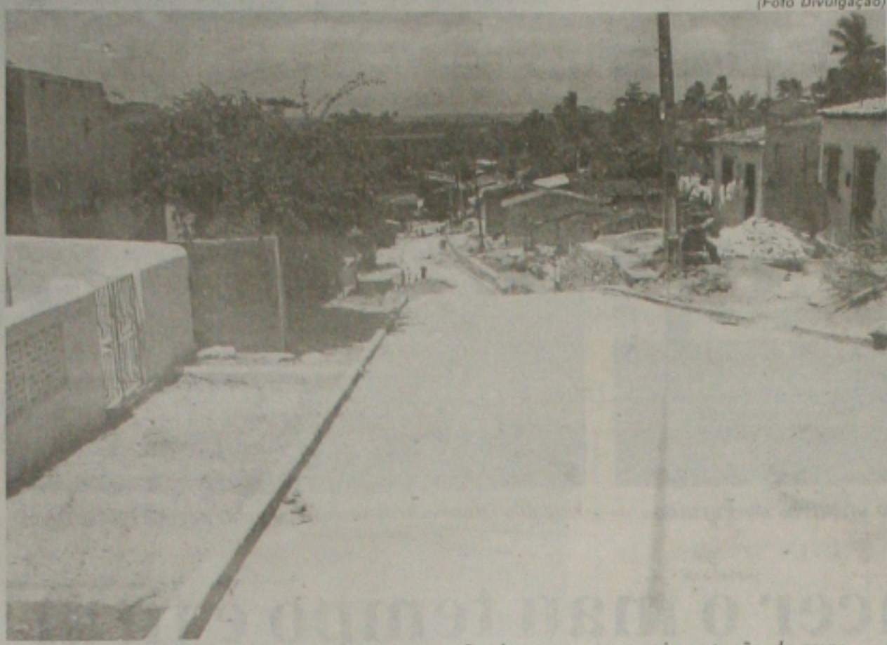
Moradores do São Carlos querem a construção de praça e a pavimentação de ruas
