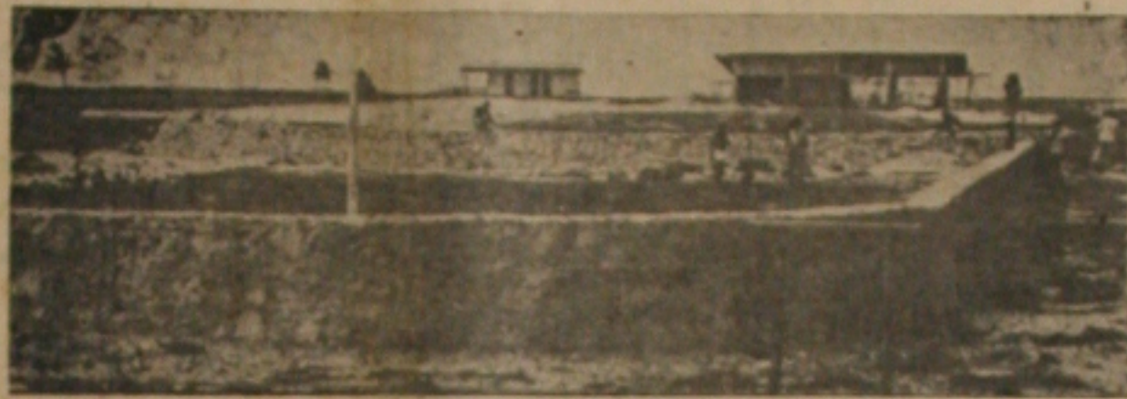
A foto ilustra aspecto da construção, vendo-se a churrascaria, ora em fase de acabamento
