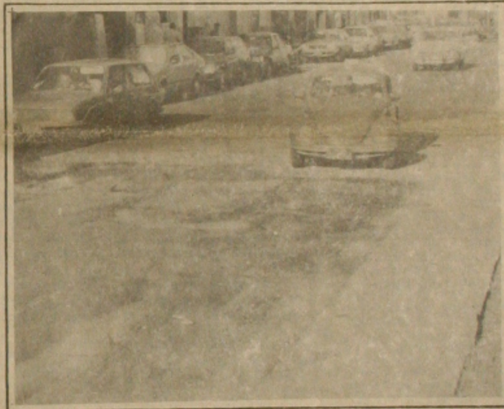
Buraco ameaça parar o trânsito na Avenida Coelho e Campos.
