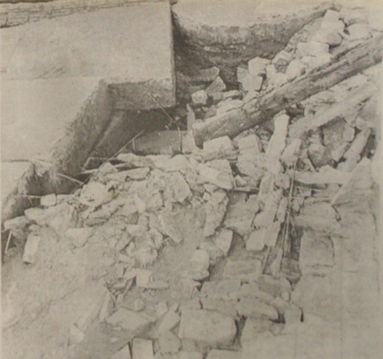
A obra já danificou o calçamento no cruzamento das ruas "M" e "B" do conjunto
